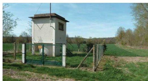
Captage Armentières 01" et son périmètre de protection immédiat
